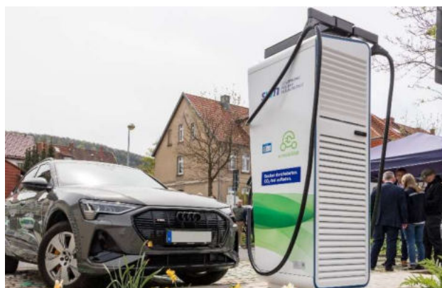
Ausbau Ladeinfrastruktur – Inbetriebnahme Schnellladesäule auf dem Parkplatz am Eichsfeld Klinikum im Mai 2023
