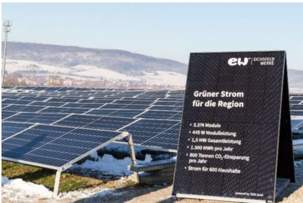
Inbetriebnahme der Freiflächenphotovoltaikanlage auf der rekultivierten Deponie Breitenworbis im Dezember 2022
