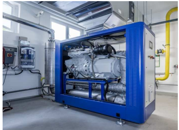
Erweiterung der Stromerzeugung durch 2. BHKW im „St. Johannesstift“ in Ershausen
