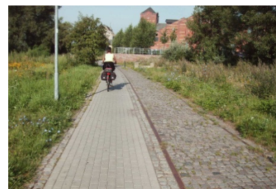
Die Verlegeart des Pflasters längs zum Gehweg führt zur unsicheren Fahrweise. Die eigentliche Fahrbahnnutzung ist eine Zumutung.
