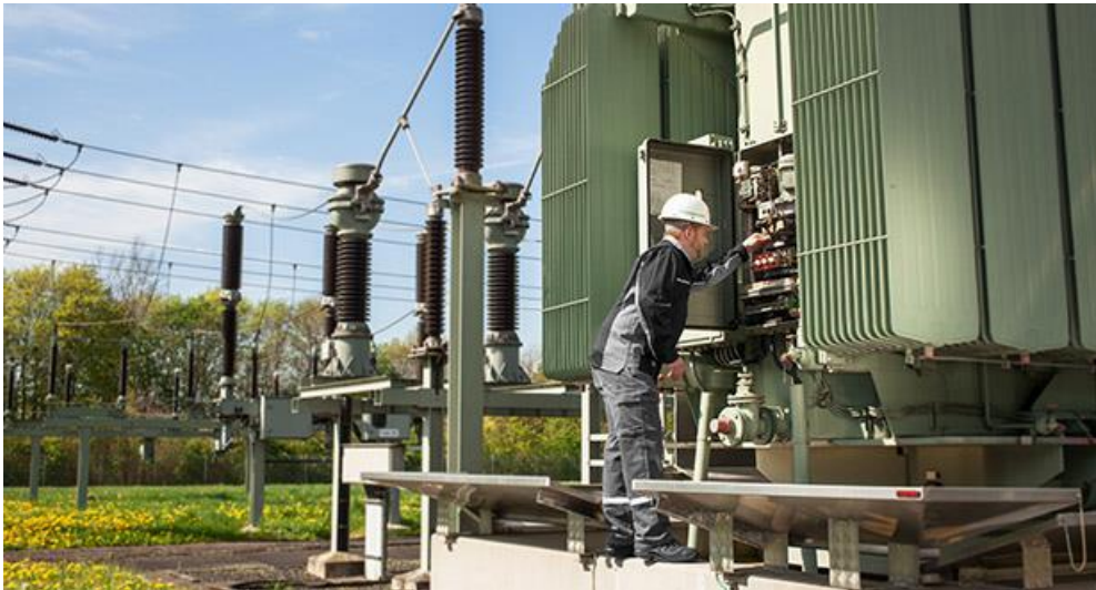
Umspannwerk der EnergieNetz Mitte GmbH
