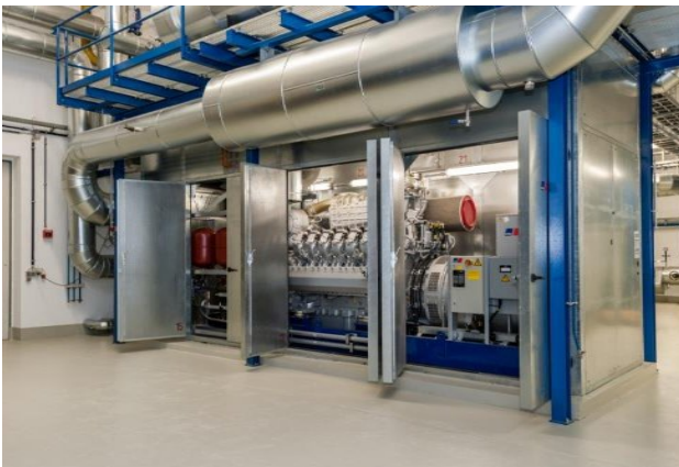
Erweiterung der Stromerzeugung im HKW Sperberwiese in Heilbad Heiligenstadt
