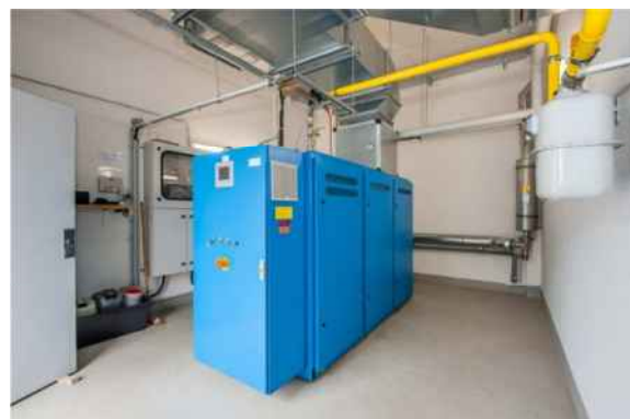
Blockheizkraftwerk im St. Johannesstift Ershausen
