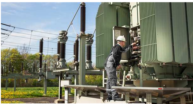
Umspannwerk der EnergieNetz Mitte GmbH
