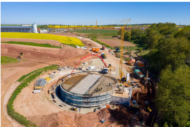
Errichtung des Hochbehälters im Gewerbegebiet „An der A38 – Ost“ in Heilbad Heiligenstadt
