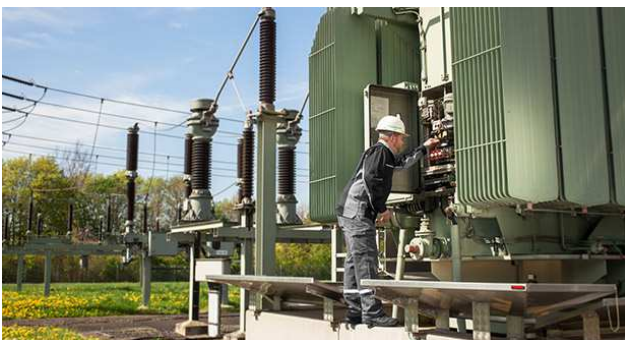
Umspannwerk der EnergieNetz Mitte GmbH
