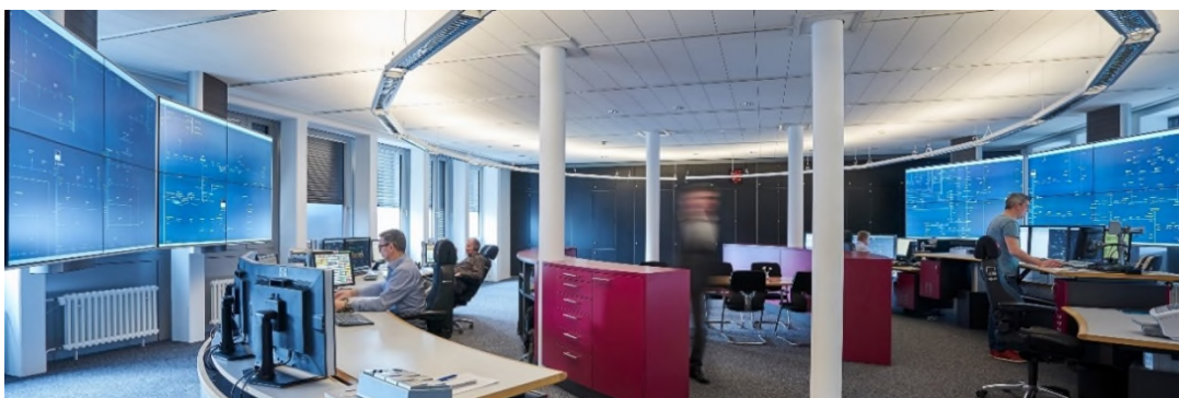
Die Netzleitstelle der EAM Netz GmbH in Baunatal (Landkreis Kassel).
