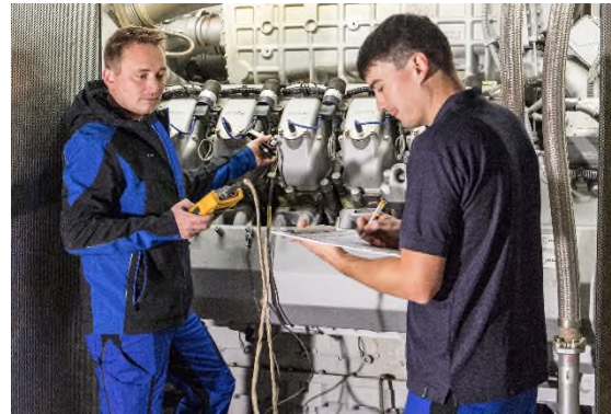
Regelmäßige Wartung der Blockheizkraftwerke durch die Ingenieure Konrad Loth und Christoph Faupel
