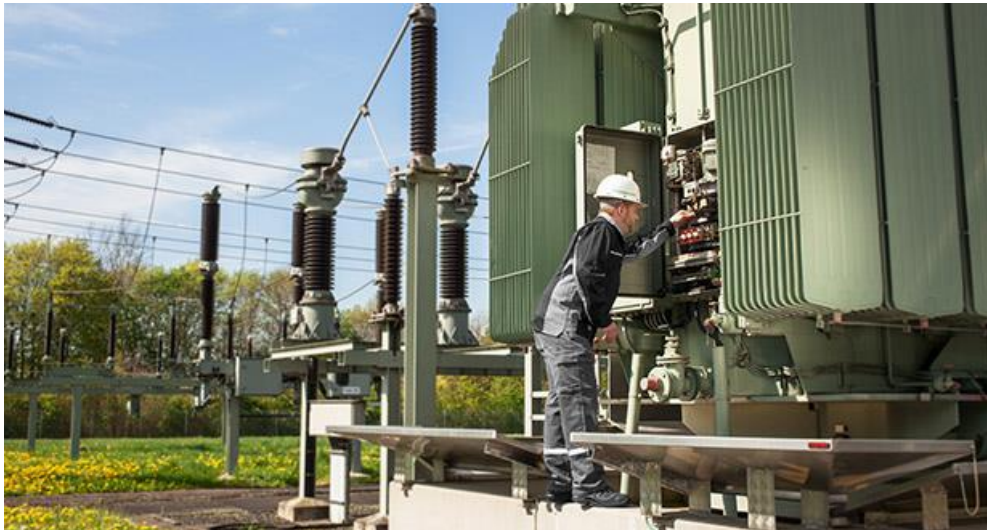
Umspannwerk der EnergieNetz Mitte GmbH
