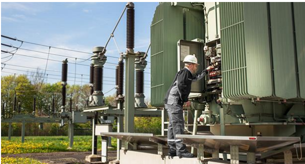
Umspannwerk der EnergieNetz Mitte GmbH
